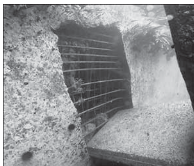
ケーソン側壁損傷部
