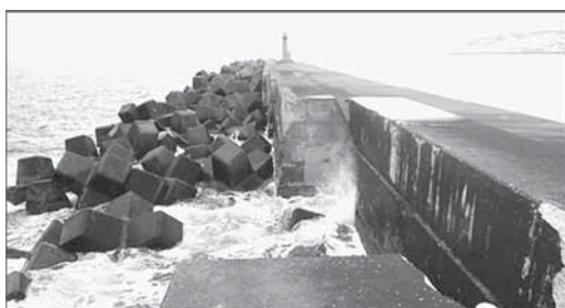
防波堤（西外）被災後のケーソン・消波工の状況
